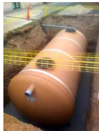
Cuve de récupération d'eau à Fresnay
